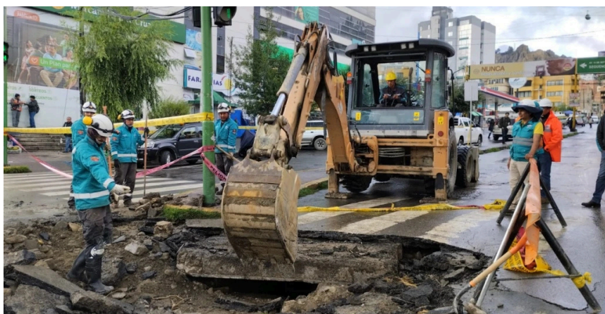
Emergencia originada por intensas lluvias en el Barrio de Obrajes, Zona Sur de La Paz. El necesario corte de vía para realizar los trabajos no fue acompañado de la planificación de alternativas de circulación diseñadas y apoyadas por logística (desvíos claros, señalización, agentes de tráfico) para ordenar y facilitar el flujo de la circulación vehicular. Imagen: Diario La Razón, 14 de febrero de 2024
