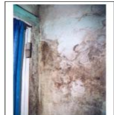
Condensación superficial en paredes
