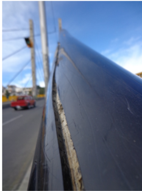
GRIETAS A RELLENAR
