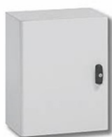
CAJA DE DISTRIBUCIÓN
