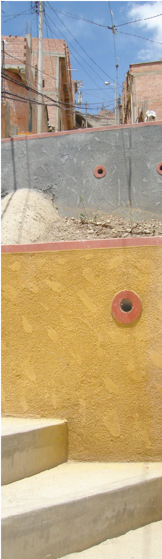
Graderías y sistema de drenaje en Barrio Faro Murillo
