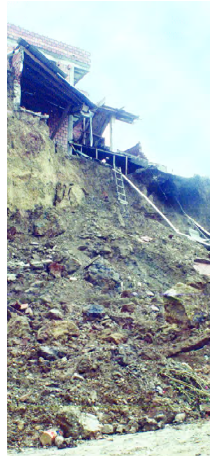
Deslizamientos de construcciones en terrenos inestables
