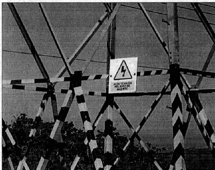
Fotografía 1, letrero instalado en una estructura metálica de la línea de transmisión
