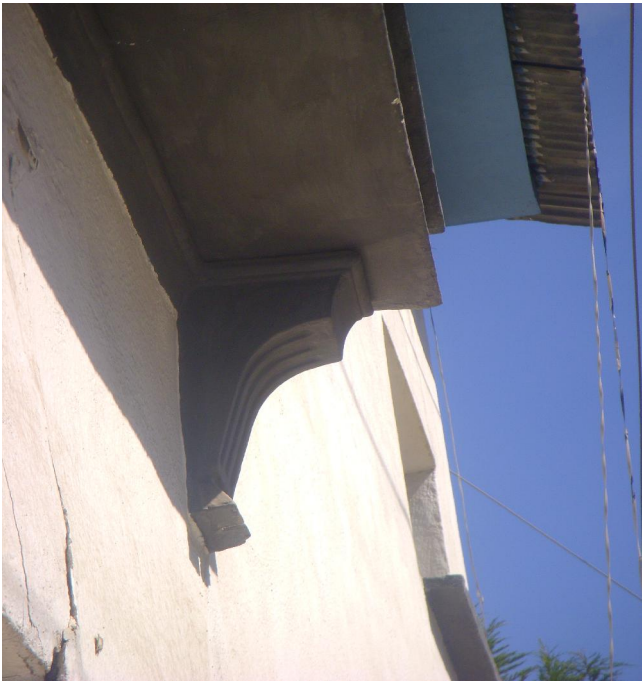
Referencia: VISTA DE LA MENSULA UBICADA DEBAJO EL BALCON Fotografía: M.CASTRO Fecha: 2009-05-01
