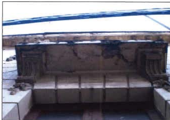
DETALLE DE RAJADURA
