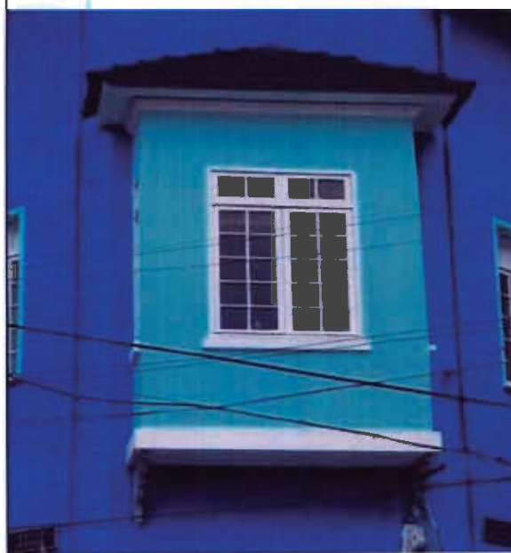
Referencia: BALCON CERRADO APOYADO SOBRE CANES EN LA PARTE FRONTAL DEL CHAFLAN Fotografía: N/A Fecha: N/A
