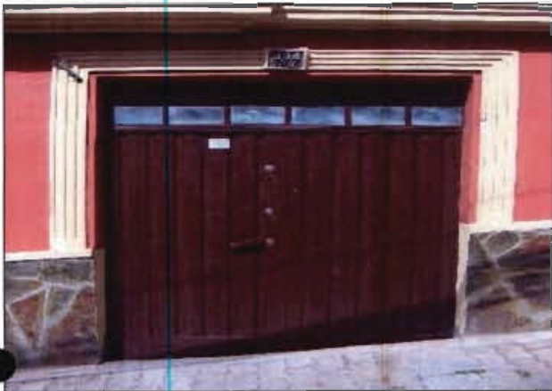
PUERTA MODIFICADA DE ACCESO VEHICULAR
