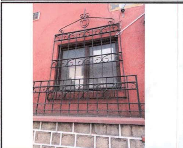
VANO AÑADIDO EN FACHADA CUANDO SE OCUPÓ EL RETIRO FRONTAL
