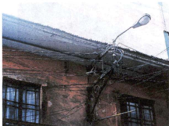
VESTIGIO DE ANTIGUO SISTEMA DE CABLEADO ELÉCTRICO
