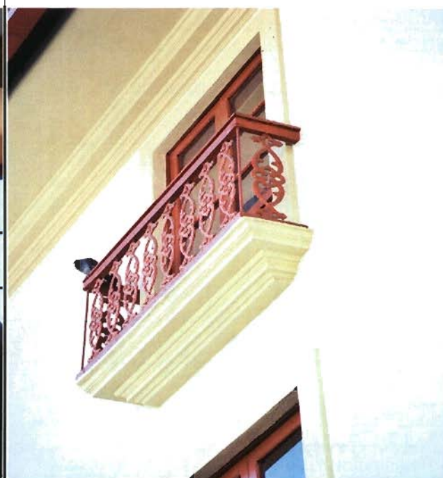
Referencia: DETALLE BALCÓN Fotografía: JBARRIGA Fecha: 2013-05-29
