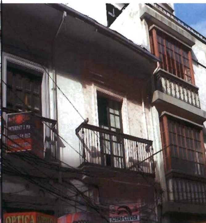
Referencia: DETALLE BALCÓN Fotografía: JBARRIGA Fecha: 2013-02-28
