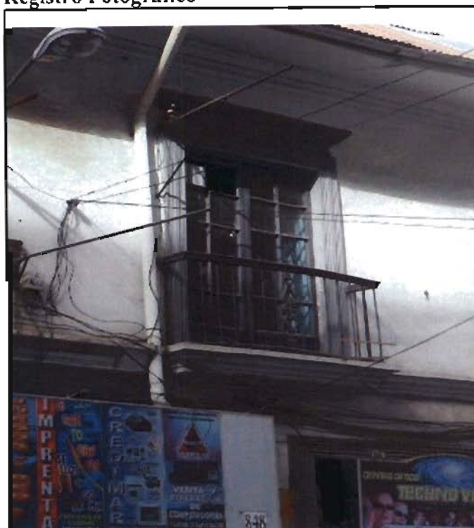
Referencia: DETALLE BALCÓN Fotografía: JBARRIGA Fecha: 2013-02-26
