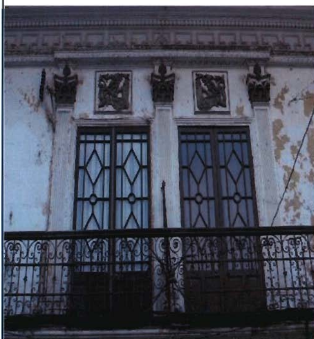
Referencia: DETALLE BALCÓN Fotografía: JBARRIGA Fecha: 2013-02-21
