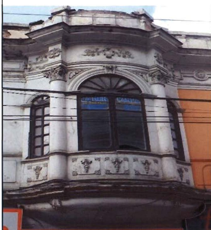
Referencia: DETALLE BALCÓN Fotografía: JBARRIGA Fecha: 2013-02-18
