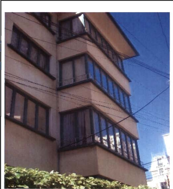
Referencia: DETALLE DE LOS BALCONES Fotografía: SIBEI Fecha: 2014-02-07
